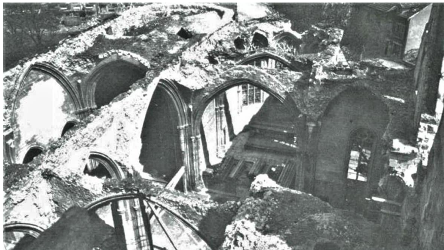
Les voûtes effondrées
